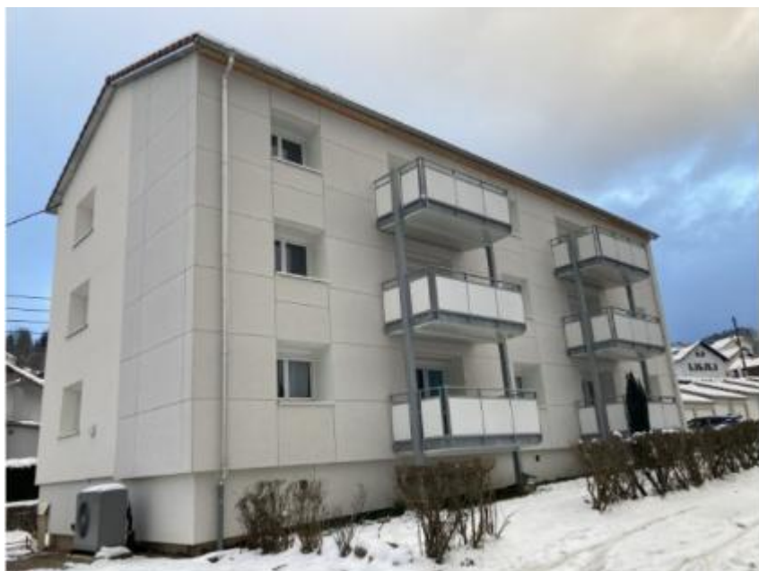
12 logements, rénovation passive Gaz indiv → 1 PAC collective de 14kW
