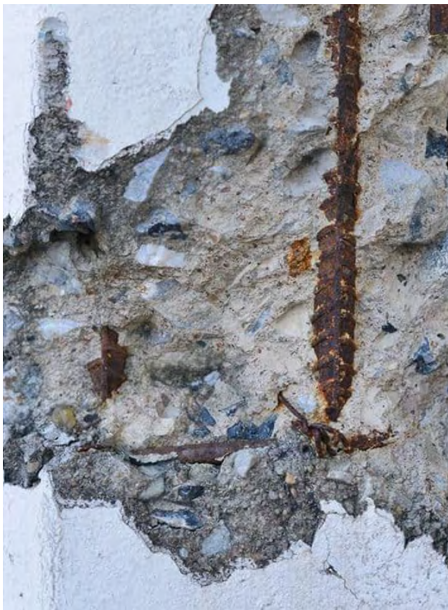
Exemple de pathologie d'un béton ancien
