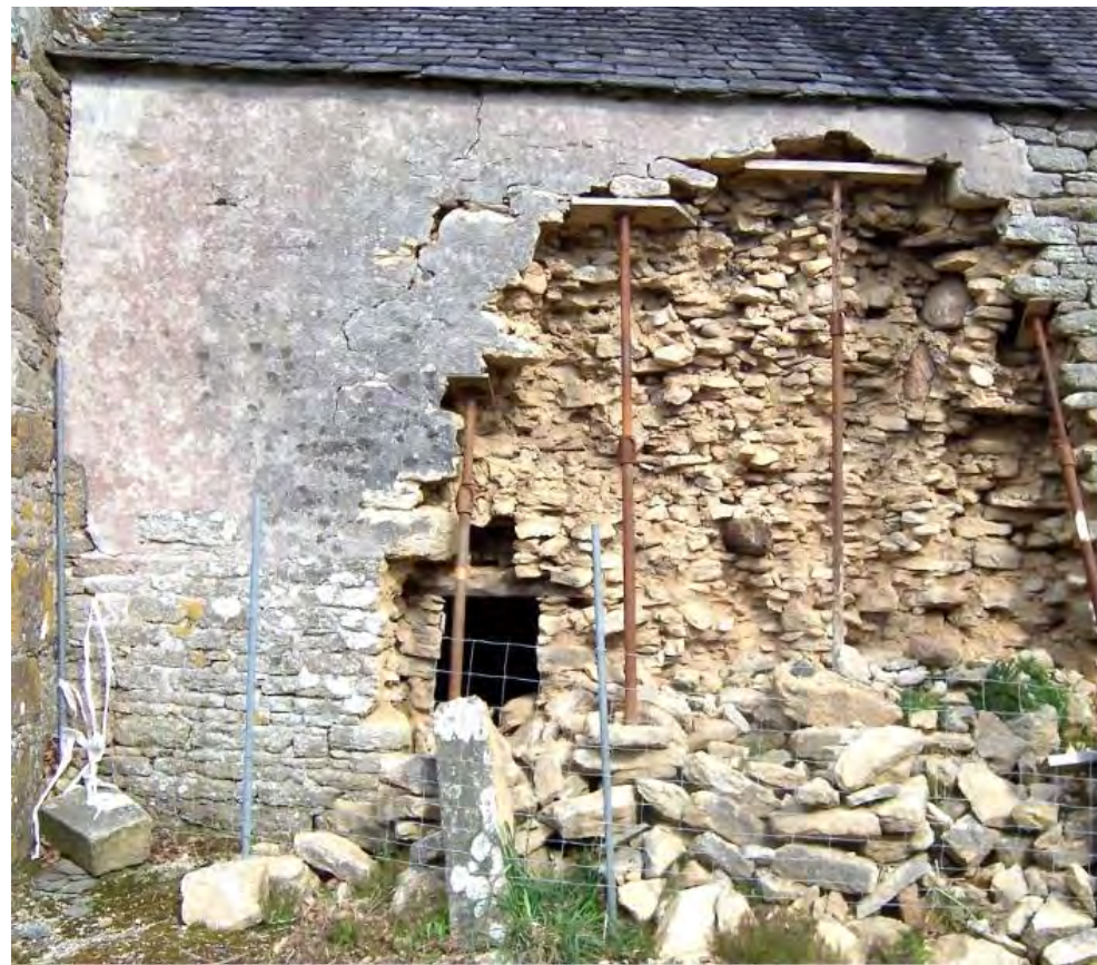
Effondrement du parement d'une maçonnerie pierre enduite
