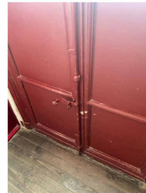
Façade rue - porte-fenêtre R+1 SV bois à remplacer à l'identique (DV) Vue depuis l'intérieur, palier escalier
