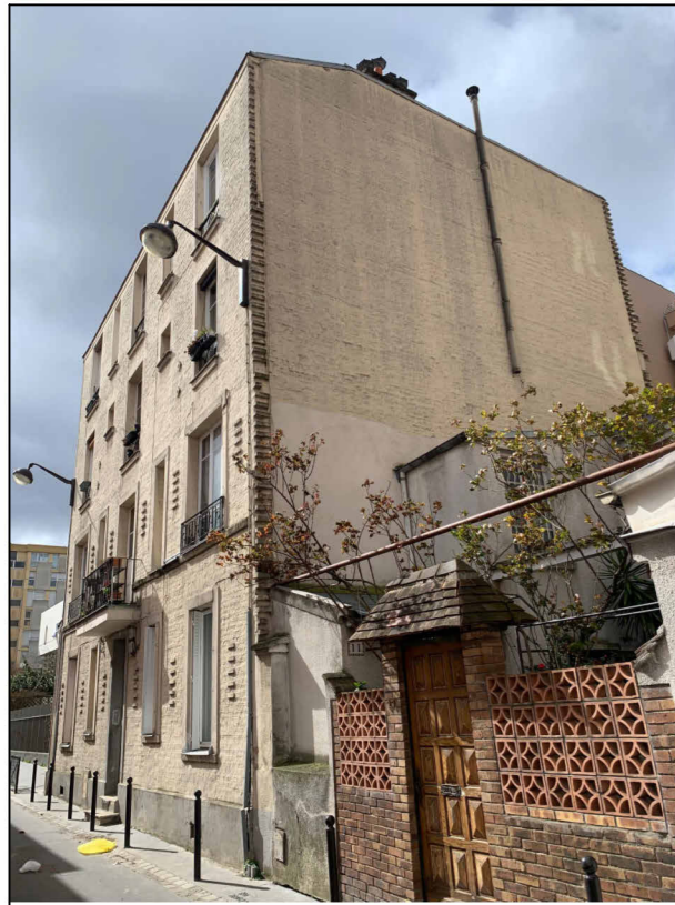
Façade rue - à ravalier ; Pignon Nord vers parcelle N°63 - à isoler
