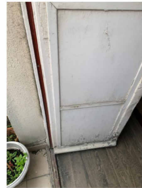
Façade rue - porte-fenêtre R+1 SV bois à remplacer à l'identique (DV)
