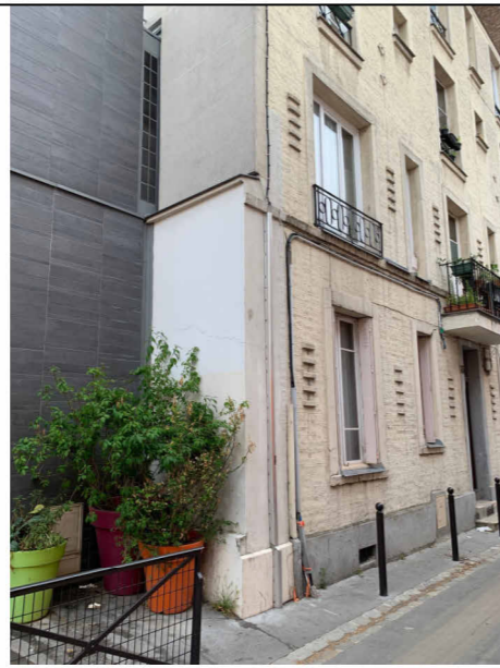
Façade rue - à ravalier ; Pignon Sud - hors intervention
